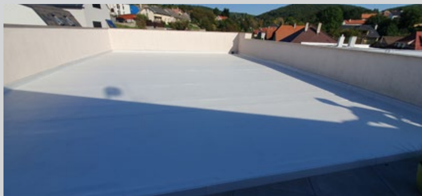
Strešná krytina nad archívom na obecnom úrade musela byť kompletne prekrytá novou
